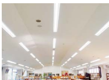
附属小学校図書室のLED照明器具
