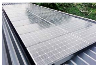
片淵団地体育館の太陽光発電設備
