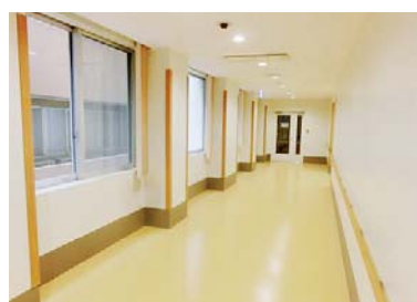
中央診療棟廊下のLED照明器具
