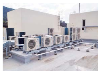
歯学部本館の空調室外機
