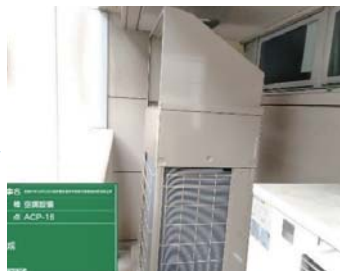
更新後 (高効率空調機)
