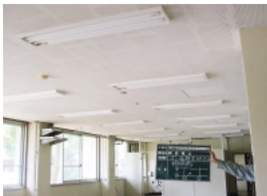
一般照明器具を設置した事務室（改修前）
