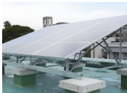
太陽光発電設備
