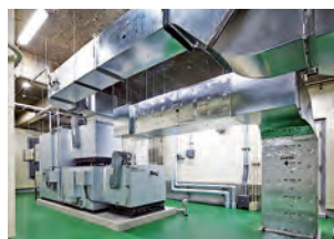
図書館医学分館の全館空調設備
