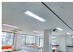
福利厚生扶養会館のLED照明器具
