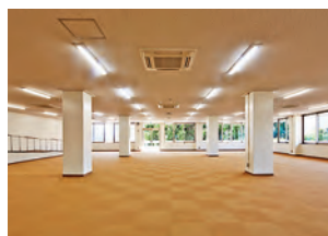
図書館医学分館のLED照明器具
