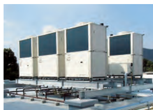
図書館医学分館の空調室外機 (GHP)
