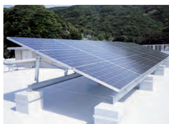
環東シナ海環境資源センターの太陽光発電設備
