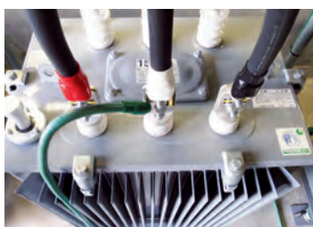
医学部基礎研究棟の高効率変圧器
