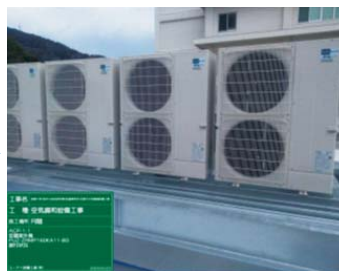
更新後 (高効率空調機)
