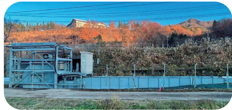
新潟県南魚沼市の農業用水路で実装されている小型水力発電装置。
