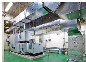
図書館医学分館の全館空調設備
