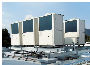
図書館医学分館の空調室外機 (GHP)
