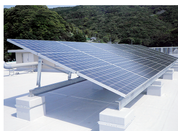
環東シナ海環境資源研究センターの太陽光発電設備
