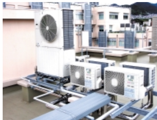
高効率の電気式空調機及びガス式空調機の屋外機
