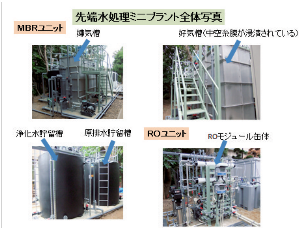
設備の各ユニットの外観
