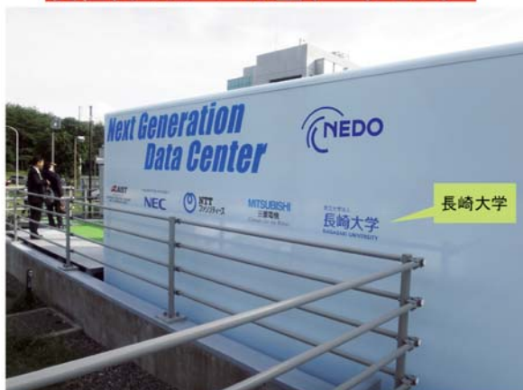
実証試験のためのモジュール型データセンターの外観
