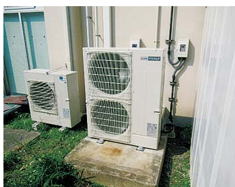
更新後（高効率空調機）
